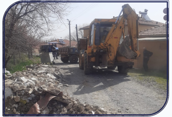
İlçemiz sınırları içerisinde gelişigüzel dökülen moloz yığınlarına müdahale
