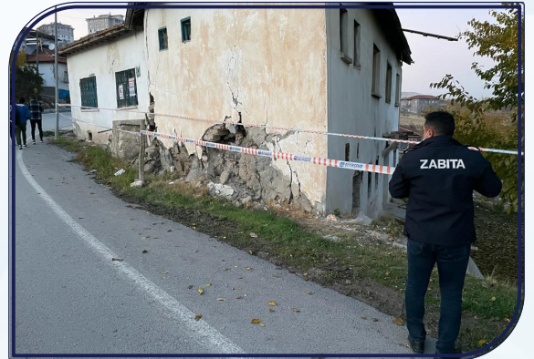
İlçemizde bulunan metruk binaların tespiti yapılarak emniyete alınıyor.
