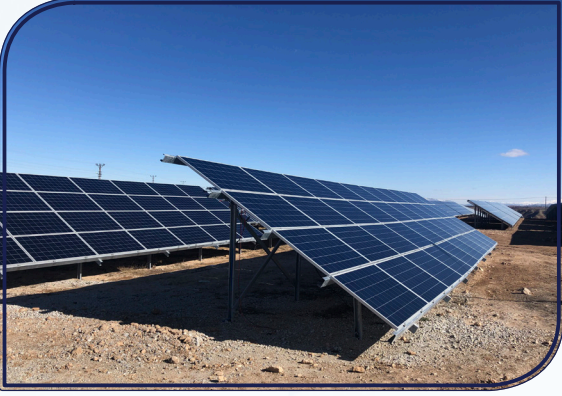
Belediye gelirlerini artırmaya dönük bir proje olarak 1 MW gücündeki Güneş Enerjisi Santralini tamamladık.
